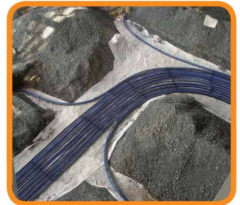
Conexión horizontal de sondas geotérmicas
